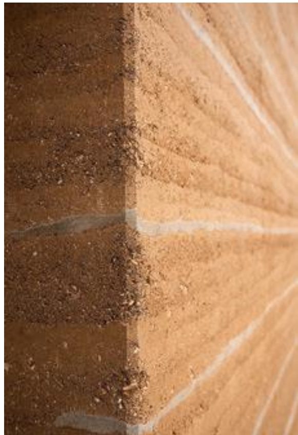
Abbildung 12: Lehmwand HRL [Elias Hassos]
