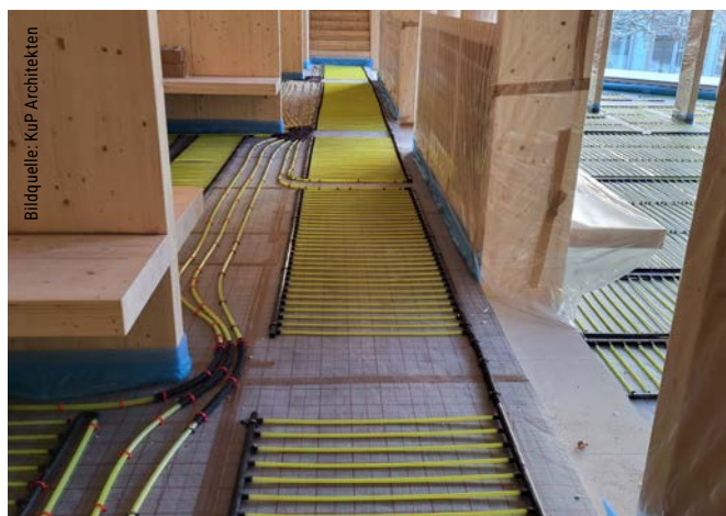
Die neue Mitarbeiterkantine hat eine mittels Wärmepumpe betriebene Fußbodenheizung erhalten.
